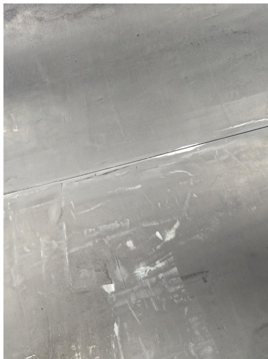
Abbildung 9 obere Hälfte: „fertig“ gespachtelt und geschliffene Oberfläche; unten: noch unebene Oberfläche durch die sogar noch der Formunterbau durch scheint
